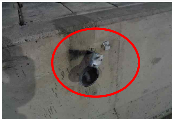
지하차도 옆 벽면 델리네이터 파손
