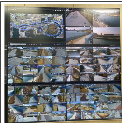
공원 내 CCTV 시스템
